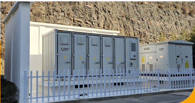
杭州某电器有限公司 1.72MW/3.44MWh储能系统 液冷集装箱储能产品
